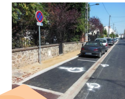
Rue Maréchal Foch, création d'une place pour Personne à Mobilité réduite (PMR) et stationnement figé en lieu et place du stationnement alterné
